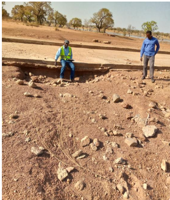
Water scaring the spill way apron
